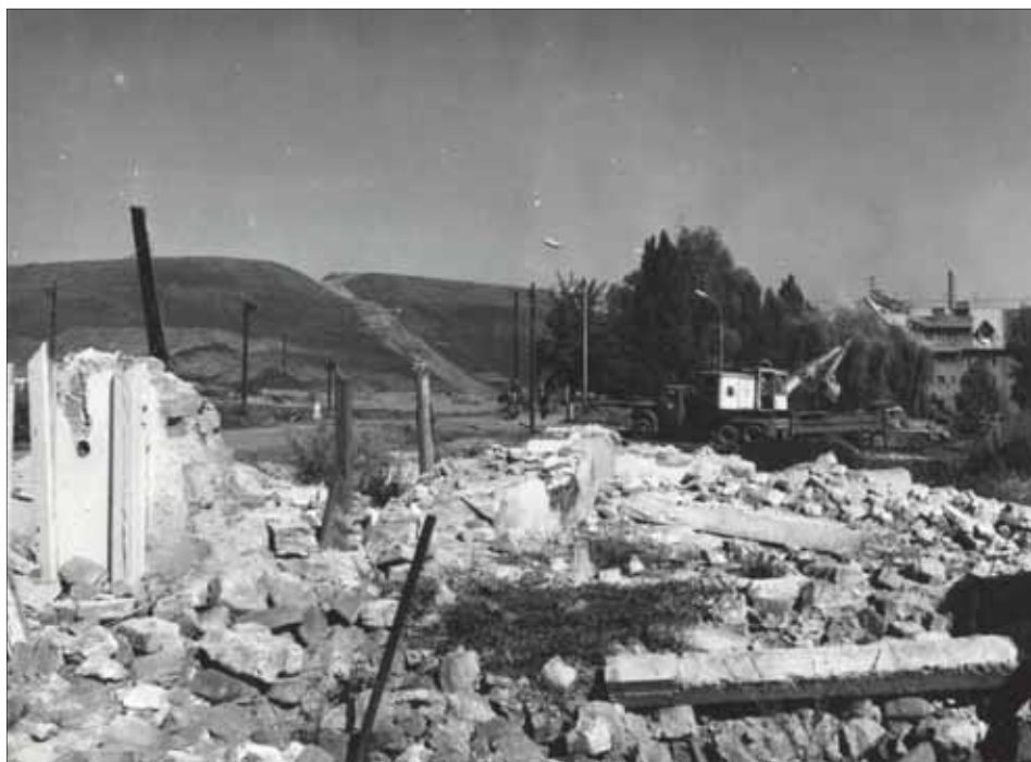
Obr. 50. Demolice obytného domu za účelem výstavby nové Místecké ulice, polovina sedmdesátých let 20. století
