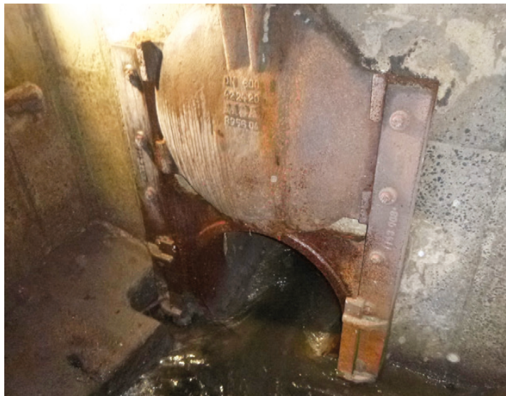
Stavitko na odtoku z OK Mostní před opatřením (otevřené, nefunkční)
